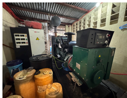
発電機・浄水室完備
